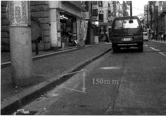
写真-8 従来の歩道の段差
